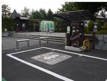
EV用急速充電施設のイメージ
