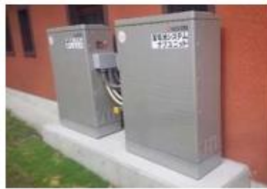
図 蓄電池システム
