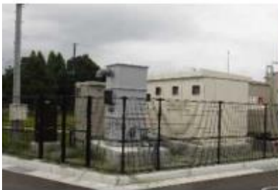
図 非常用発電機
