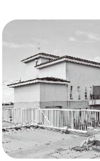
老朽化が進む浄化センター（岡田地内）
