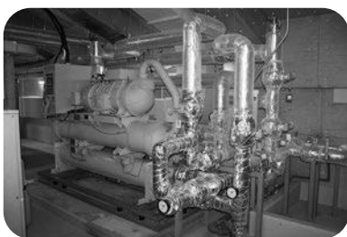
地下水を利用した現在の図書館の空調設備
