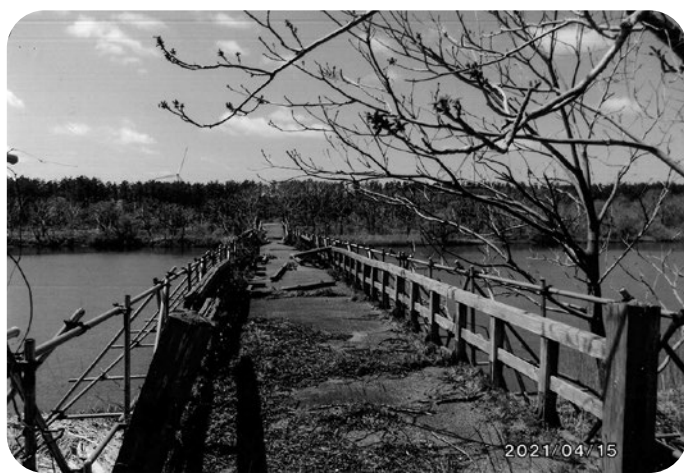
栄橋の破損 (白木地内)
