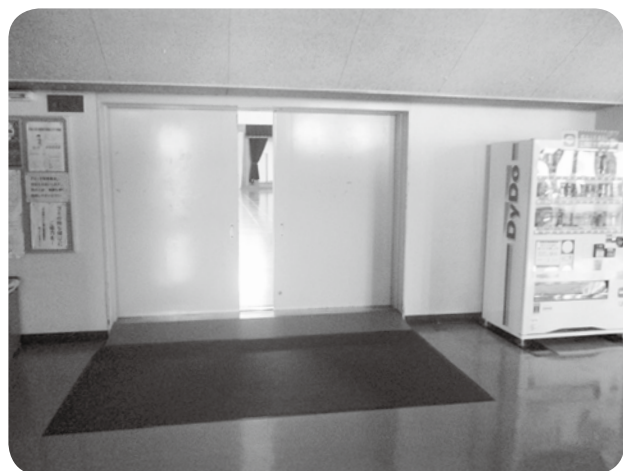
完全に閉らない町民体育館 西側防火扉
