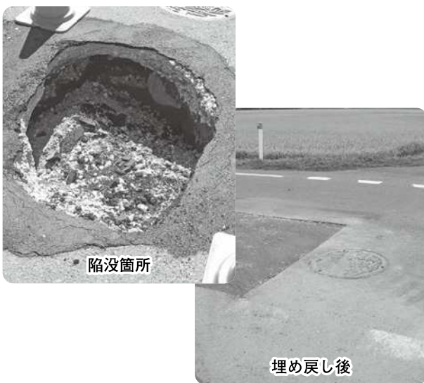
町道の陥没箇所 下水道管も補修時期に
