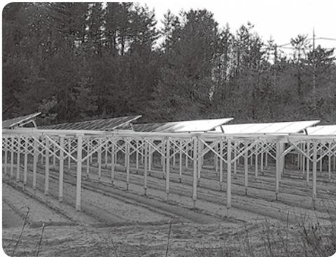
農地での営農型太陽光発電施設(藤崎地内)
