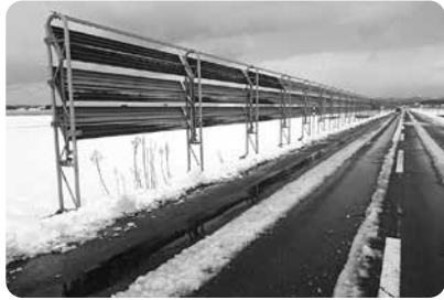
老朽化している防雪柵
