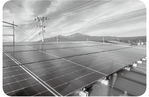
屋根に設置された太陽光パネル
