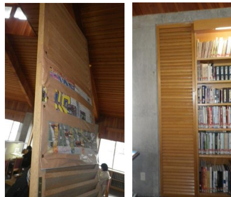
新聞紙で給気口を部分的に遮蔽 (空調の目隠しの裏)
